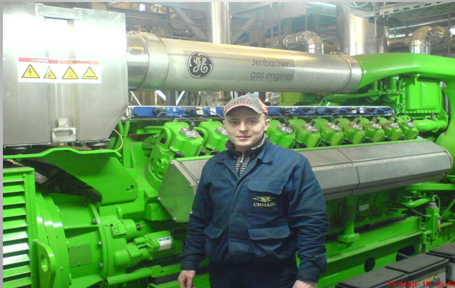
Пепси Кола (Сандора ТМ), 2.8 МВт е
