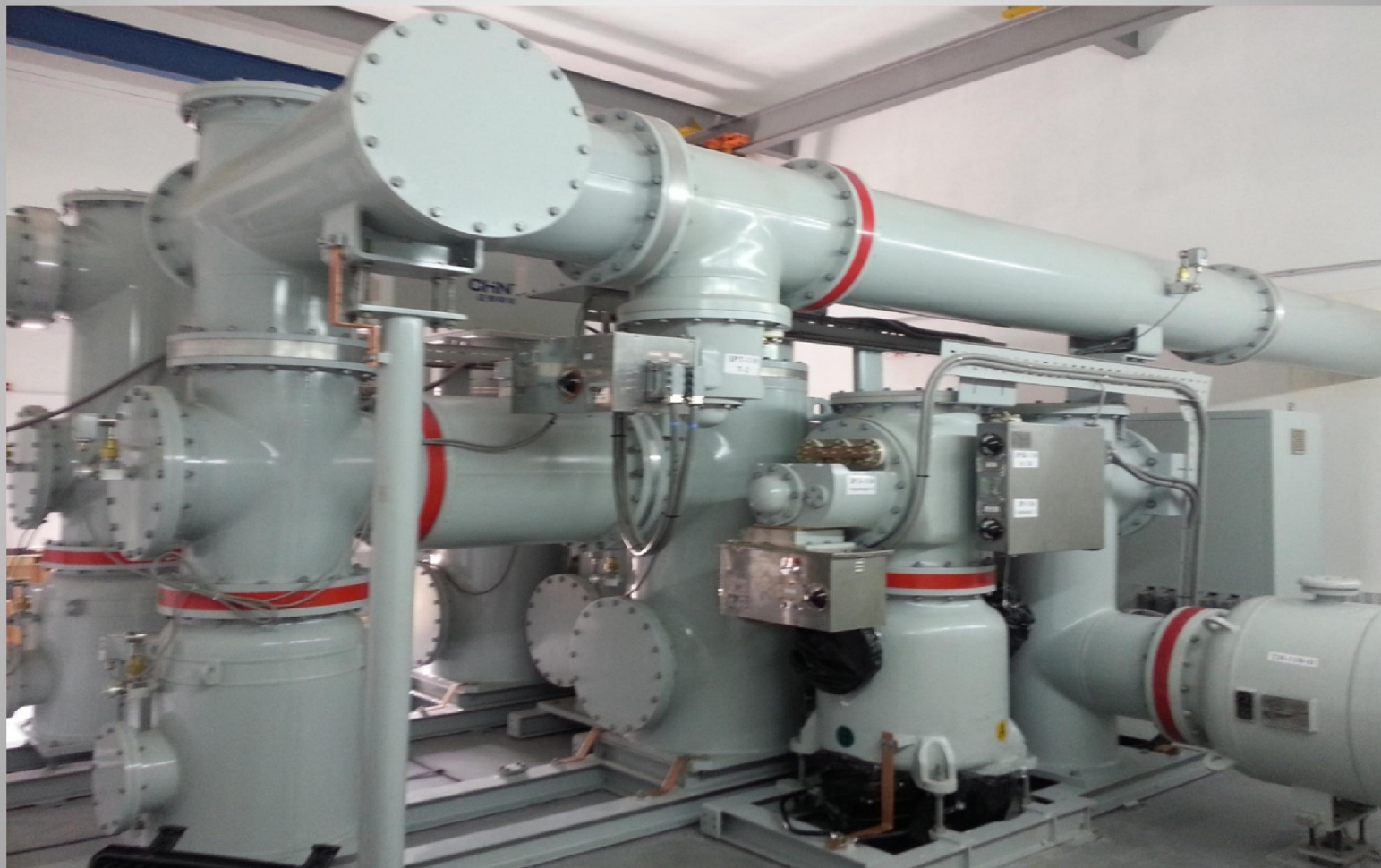
Элегазовые распределительные системы 110 кВ
