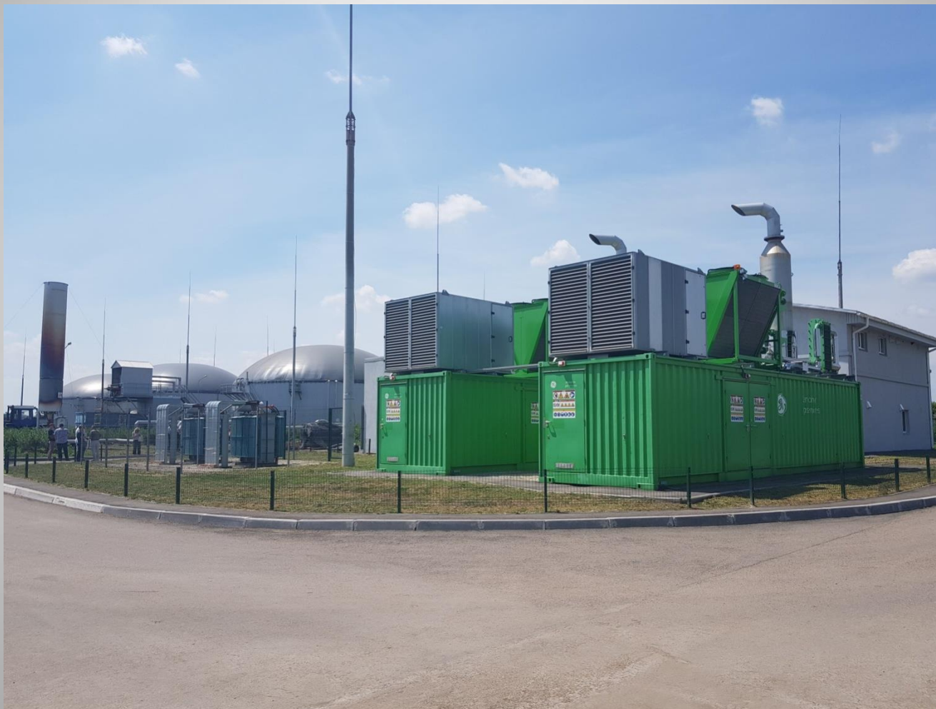
Biogas. Rakitnoe Sugar Refinery Plant, 2.4 MW eI
